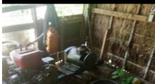
Schulhof und Dieselgenerator
